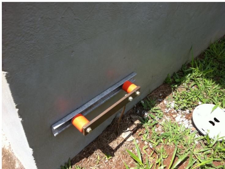
Figura 26 – Barra de cobre para aterramento dos equipamentos de descarga de óleo diesel Fonte: ilustração fornecida pela Empresa A
