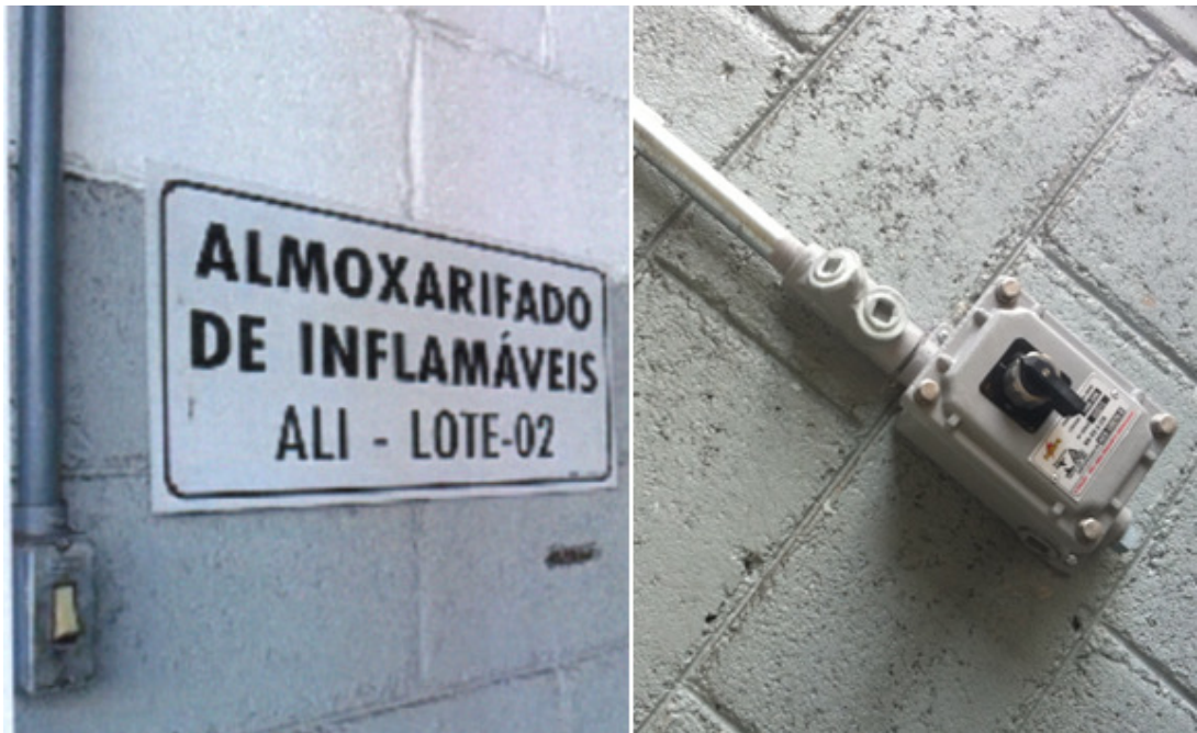
Figura 19 – Troca dos equipamentos elétricos em área de armazenamento de produtos inflamáveis
