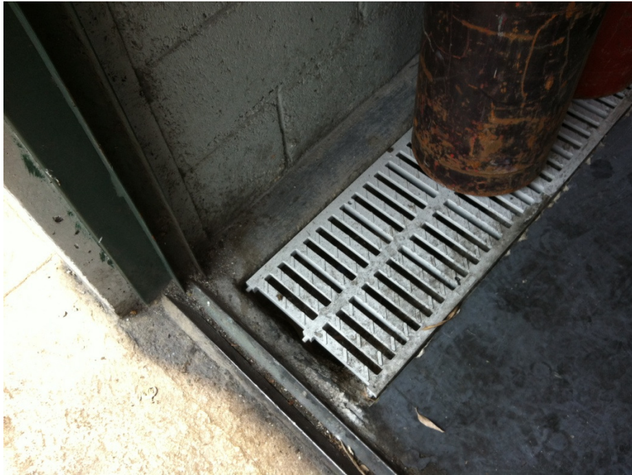
Figura 21 – Adequação das canaletas na área de armazenamento de produtos inflamáveis
