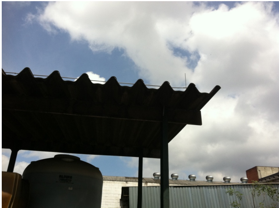
Figura 27 – Instalação de SPDA, estando este interligado com o sistema dos demais edifícios
