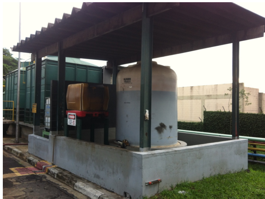
Figura 23 – Área de contenção revestida com material resistente aos possíveis vazamentos dos produtos armazenados Fonte: ilustração fornecida pela Empresa A
