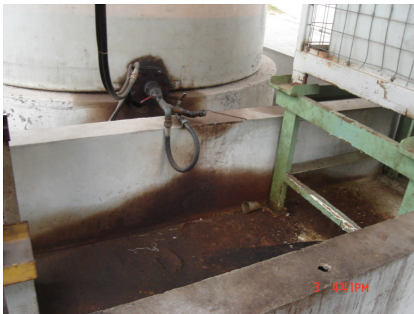
Figura 17 – Bacia de contenção de ácido sulfúrico com absorção de produto químico na alvenaria
