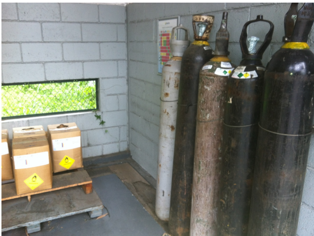
Foto 15 – Caneleta de contenção de produtos químicos obstruída Fonte: ilustração fornecida pela Empresa A
