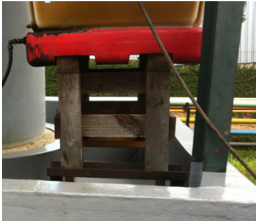
Figura 16 – Suporte de madeira para sustentação de reservatório de óleo diesel
